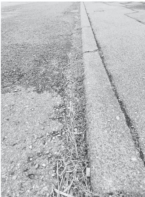
Unkrautwuchs entlang der Bordsteine
